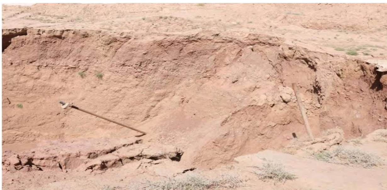
Рисунок 1. Провальное явление вокруг буровой скважины [6]
